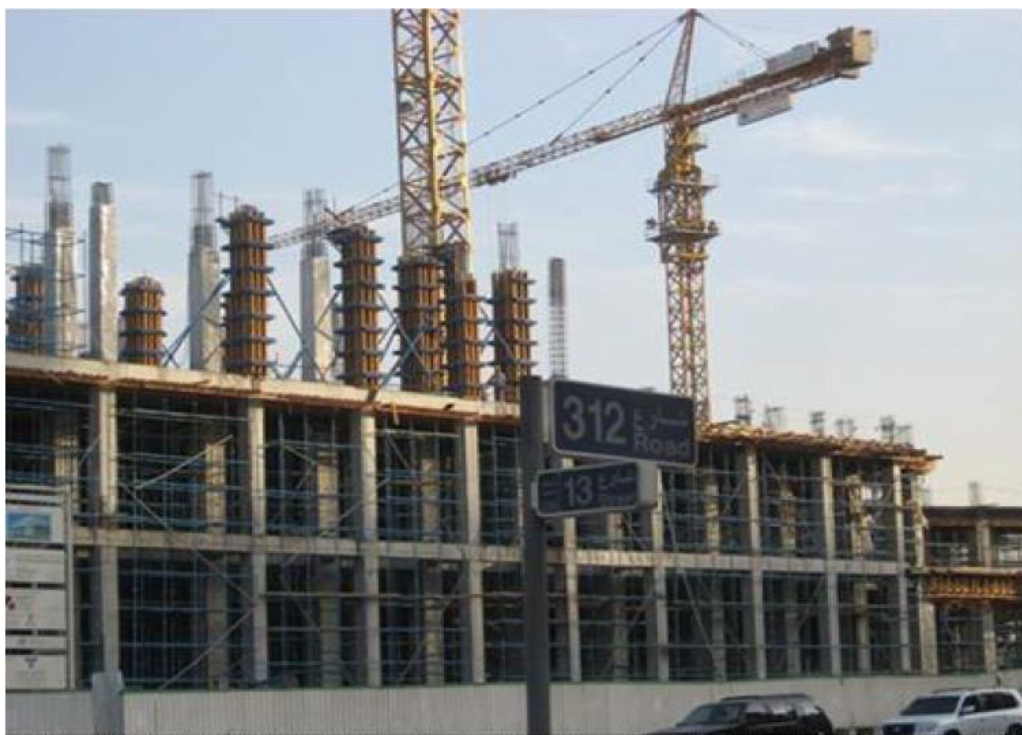
Рисунок 3.2 - Возведение здания высотой 20 этажей с применением традиционных опалубочных систем (г. Дубай, 2008 г.)
